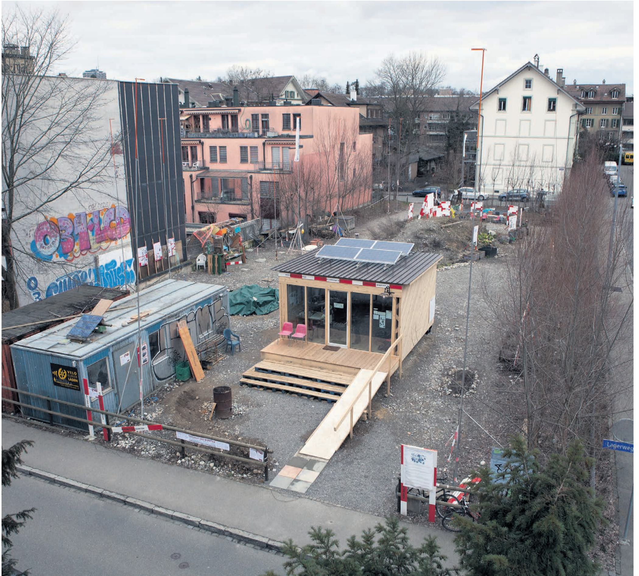
In zwei Wochen von Hand gebaut, aus Emmentaler Holz und mit vorbildlicher Wärmedämmung: Das «Böxli» auf der Brache am Berner Centralweg zeigt, dass ökologisches Bauen kein Luxus sein muss.
